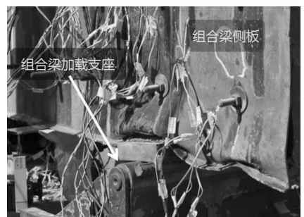
图 4 非典型钢板局部屈曲破坏位置 Fig. 4 Atypical local buckling of steel plate
